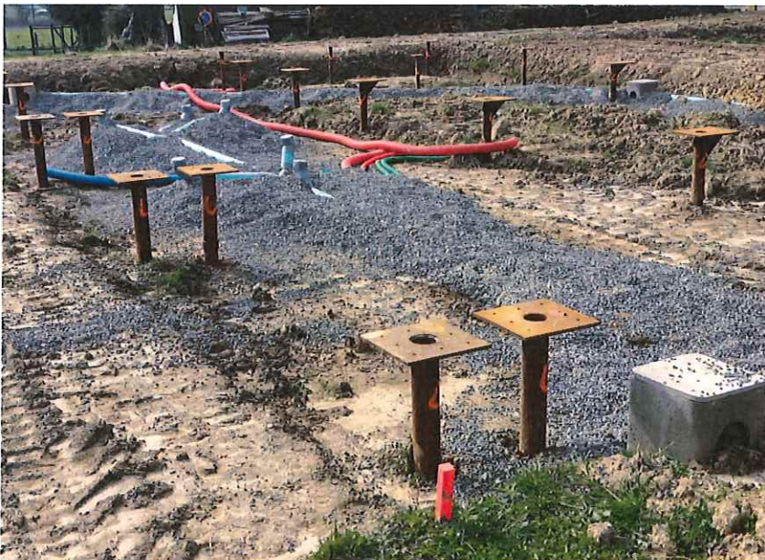
Les maisons sont posées sur technopieux, enfouis à 4 mètres de profondeur. Sur la partie privative, les réseaux courent en surface, non enterrés.
